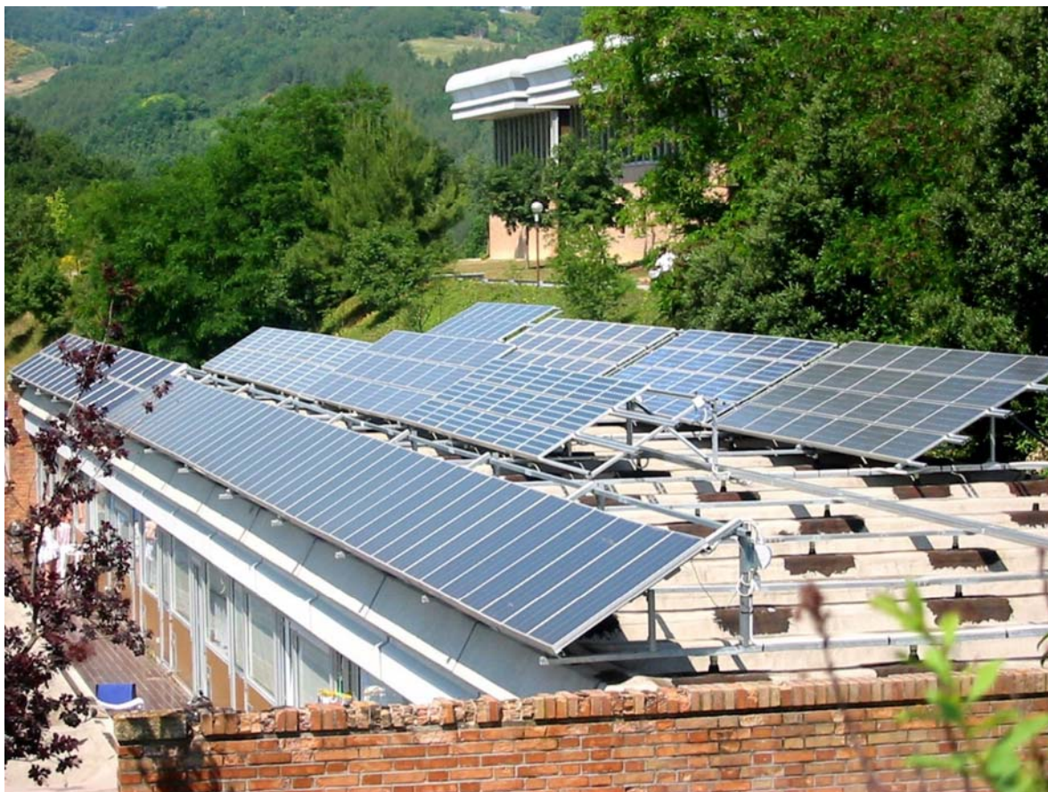
Fig. 5.1 - Vista dell'impianto fotovoltaico della “ex-Sogesta”.
